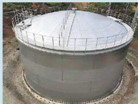
緑台高区配水池の更新後
